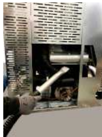
Fig. 141 - Nettoyage de le ventilateur ambiant
