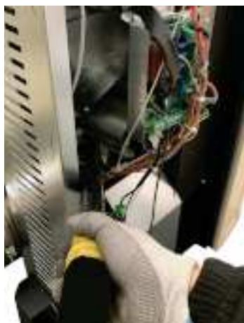
Fig. 140 - Nettoyage de le ventilateur ambiant
