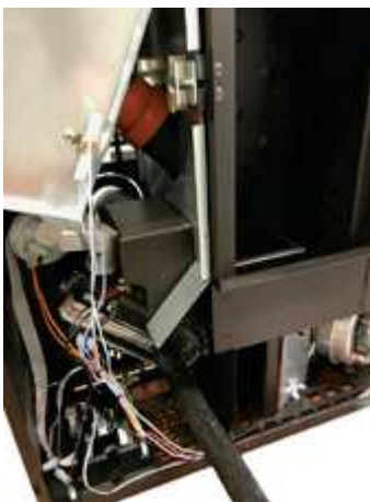
Fig. 102 - Nettoyage de le ventilateur ambiant
