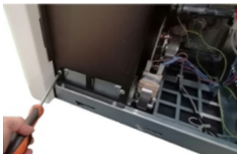
Fig. 95 - Nettoyage de le ventilateur ambiant
