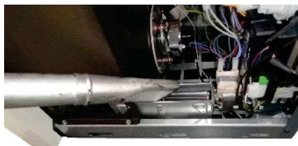
Fig. 110 - Nettoyage de le ventilateur ambiant
