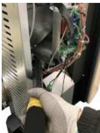
Fig. 90 - Nettoyage de le ventilateur ambiant
