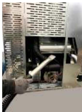
Fig. 91 - Nettoyage de le ventilateur ambiant
