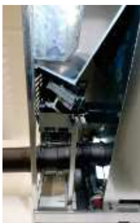
Fig. 68 - Sortie de fumées postérieure Sharp
