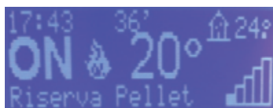
Fig. 22 - Réserve de granulés de bois
